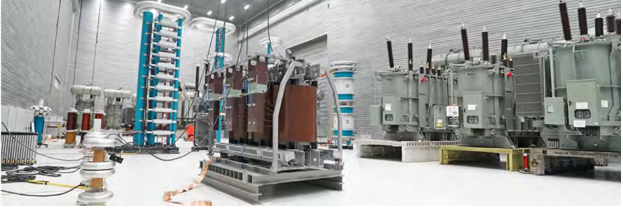
Astor Enerji Test Laboratuvarından bir bölüm
